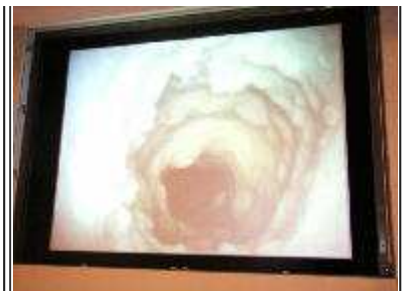
小便器の排水管の内部は尿石が固着している
