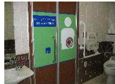
オストメイト設備のドア。 不必要時には設備を隠しておける。
