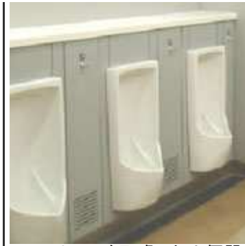
メンテナンスを配慮した小便器。シンプルな形状。
