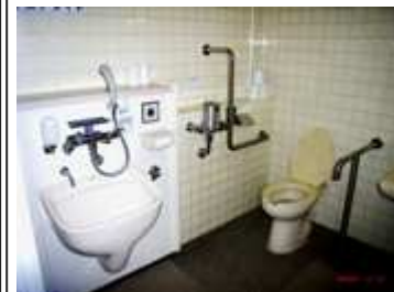
設置が義務化されたオストメイト設備(手前)。シャワーやフックが付帯されている。
